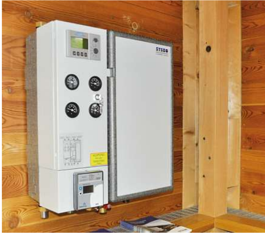
Ab sofort bei der Ortsgemeinde Mels zur freien Besichtigung: Eine eigens installierte Muster-Fernwärme-Unterstation.
